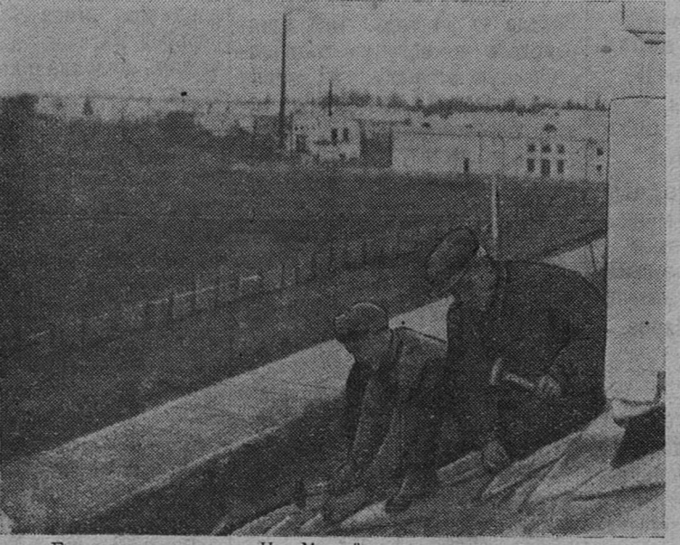
Бригада плотников И. Михайлова — одна из лучших в строительном управлении № 2 треста «Ленинградсланец». На снимке: И. Михайлов (справа) и Н. Шолков за устройством кровли нового дома в Больших Лучках. Фото П. Вересова.
