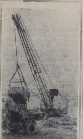
Новая Каховка. Машинист экскаватора А. Дергунов, работа на погрузке гранитного щебня, выполняет до трех норм в смену. На снимке: экскаватор, управляемый Дергуновым, за работой.
