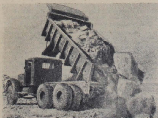
Куйбышевгидрострой. Мощные автосамосвалы Ярославского завода на строительстве перемычки котлована под здание Куйбышевской ГЭС.
