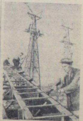
Куйбышевгидрострой. Монтаж мачт-опор для подвесной дороги, которая соединит районы строительства Куйбышевской гидроэлектростанции, расположенные на разных берегах Волги. На переднем плане — бригадир монтажников М. Соболев за сборкой мачты-опоры. Фото Н. Финникова.
