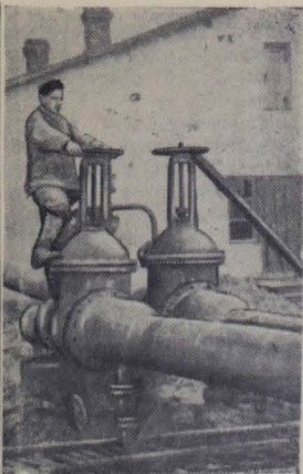
На снимке: у теплофикационной линии Рудничный — Большие Лучки.
