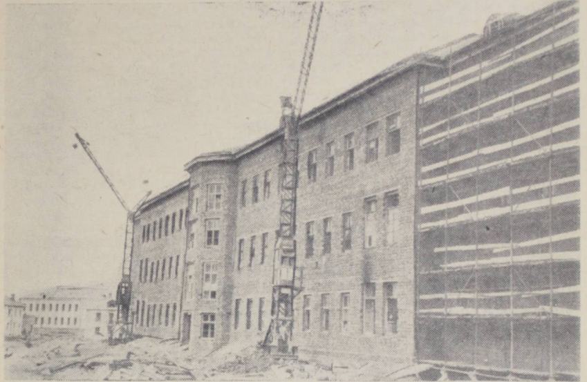
На снимке: Строительство здания новой больницы в пос. Большие Лучки. Фото И. Баранова. (ЛенТАСС)
