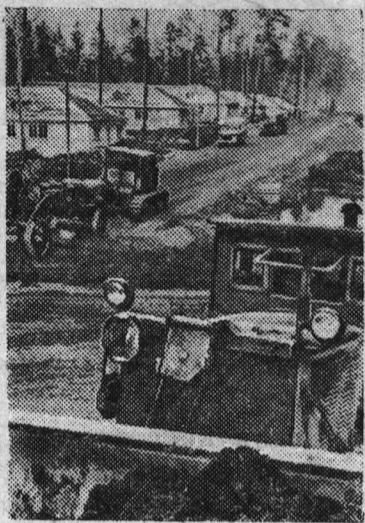
На снимке: строительство новых дорог к станции Осиновка и к промышленным предприятиям новостройки.
