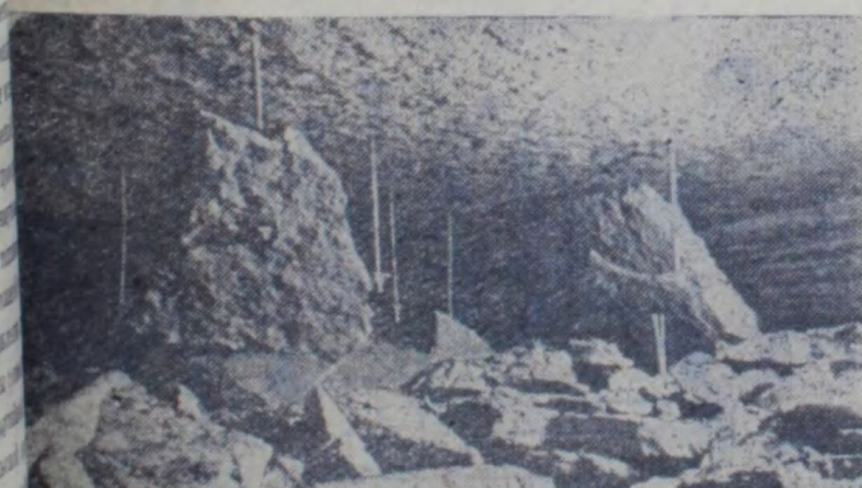
На снимке: второе обрушение кровли. Вид в сторону забоя
