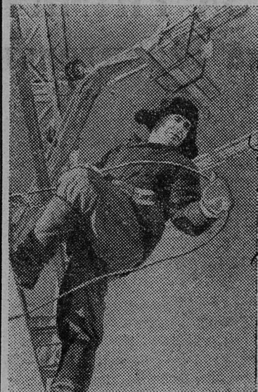
СВЕРДЛОВСКАЯ ОБЛАСТЬ. На строительстве Белоярской атомной электростанции имени И. В. Курчатова. НА СНИМКЕ: Герой Социалистического Труда А. С. Лебедев в момент монтажа главного ввода.
