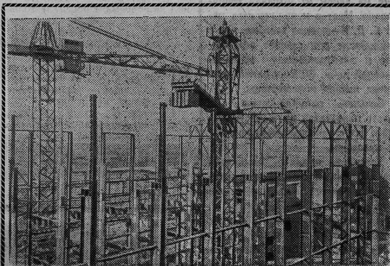
Развернулось строительство третьей очереди Тахиташской ГРЭС в Каракалпакской АССР. С вводом ее в строй общая мощность станции достигнет двухсот тысяч киловатт. На снимке: строительство третьей очереди станции. Фото А. Ходакова.
