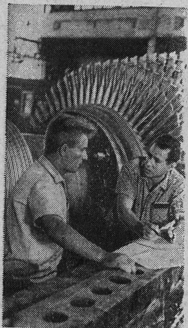
На Краснодарской ТЭЦ начат монтаж первой в стране уникальной газовой турбины мощностью 100 тысяч киловатт. Она разместится рядом с четырьмя действующими паротурбинными установками. Для нее возведено специальное современное здание.
