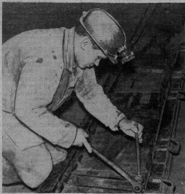
НА СНИМКЕ: проходчик наращивает скребковый конвейер после того, как пройдено определенное число погонных метров горных выработок. Фото Ю. Власова.
