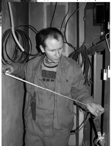
На снимках: электромонтажники С.К.Аносов и А.Д.Андрянов ведут работы на бетонобетонном узле ООО «Цемент»; А.Г.Крутилов руководил работами в офисно-гостиничном комплексе ООО «Цемент».
