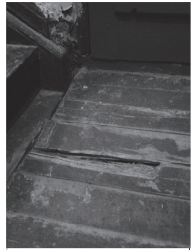
Дыры между деревянными половицами
